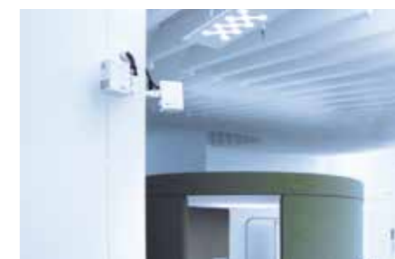
Condairs luftbefuktningssystem NanoFog Evolution i Fraunhofer IAO
