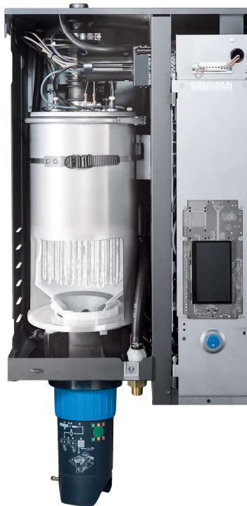
Kalkavlagringar på värmeelement
